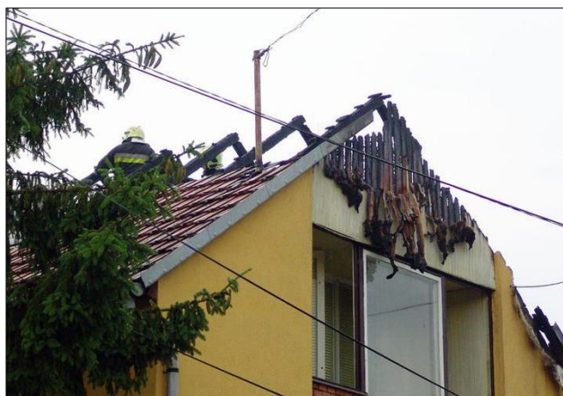
1. kép: Villám elsődleges hatására kigyulladt épület. A villámvédelmi rendszer („villámhárító”) feladata, hogy közvetlen villámcsapás esetén megővje az építményt a tűz keletkezésétől, és a személyeket érő áramütéstől.
